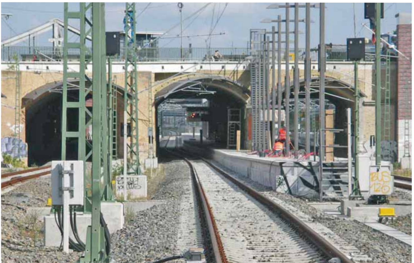
Bild 7: Abnahme der Erdungsanlagen
