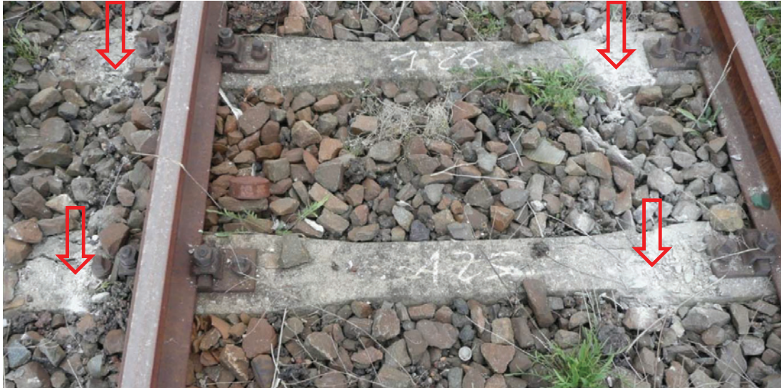
Abbildung 2: Beispielhafte Beschädigungen von Betonschwellen bei Weiterfahrt eines entgleisten, unbeladenen Wagens, aufgenommen am 11.10.2007 in Berlin-Schöneweide, Radsatzlast 7,5 t
